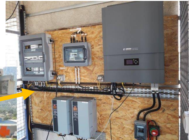
Coffret électrique, Onduleur, Variateurs, parc batterie
